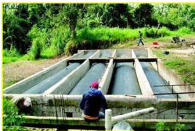
Figura 23 Biodigestores tipo tubular cuádruple r expuesto al aire libre, pudiendo techarse para una mejor conservación.
